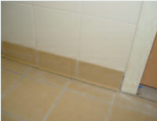
Hier zijn zogeheten holle plinttegels in de kleur van de vloertegels gebruikt. Nog beter is het de kleur van de wandtegels of een geheel andere, contrasterende kleur te gebruiken.
